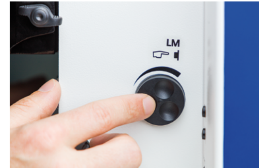
Commande de la gestion d'éclairage
